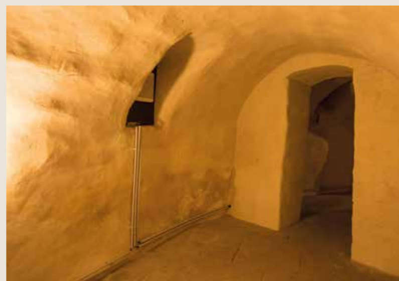
Reversibel: Fortluftventilator und Anschlüsse in einer Fensternische der Krypta.
