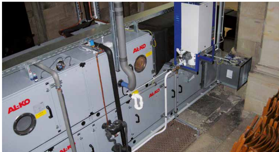
Teilansicht des Klimagerätes, welches im Dom aufgestellt wurde.
